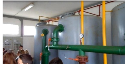
Traitement de l'eau brute dans des cuves.
